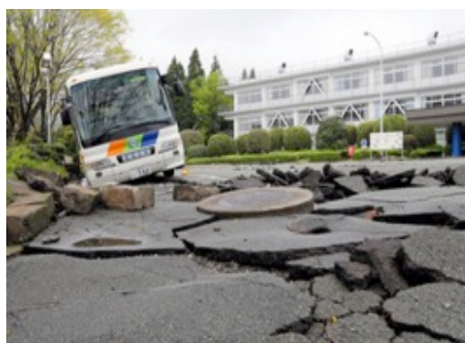
図 2 : 講義棟前に新たに見つかった断層周辺の被害
