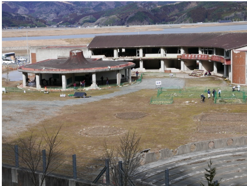
宮城県石巻市立大川小学校校舎 2020/2/1 (現地調査で撮影)
